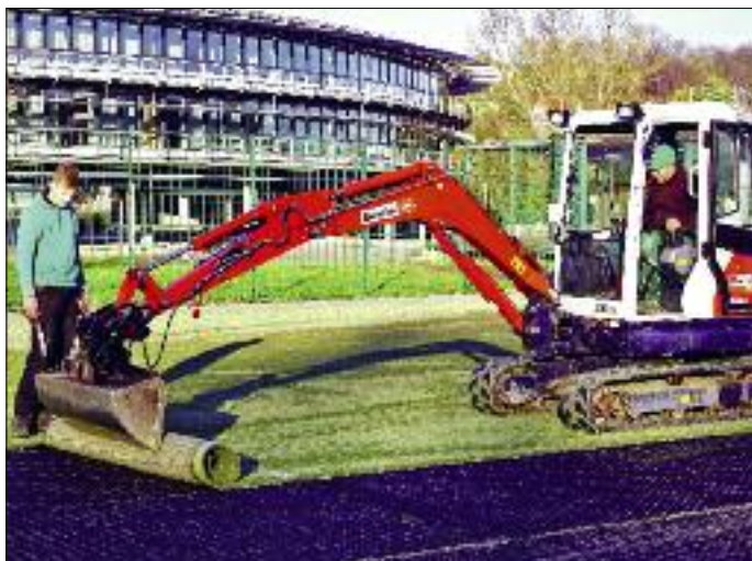
Im Auenstadion Flöha wurde in den vergangenen Wochen der Kunstrasen erneuert. Hier sind Tobi Schwabe (links) und Patrick Hirmer von der Firma KRB Torgau damit beschäftigt, den alten Belag aufzunehmen und für den Abtransport vorzubereiten. Foto: Knut Berger
